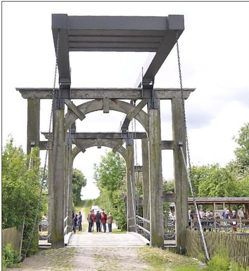
Die Zeit der Sperrungen ist vorbei: Die Schleusenbrücke in Kleinkönigsförde wurde nach der aufwendigen Sanierung jetzt wieder frei gegeben. Foto kvs
