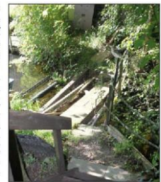
Die Steganlage zwischen den einzelnen Gebäuden der Schleusenanlage ist nicht mehr funktionsfähig.
