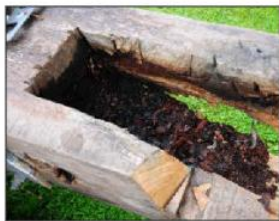
Dieser Eichenbalken von der Klappbrücke an der Eiderkanalschleuse ist rott.
